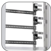
Шины на изоляторах для удобной разводки магистральных проводов
